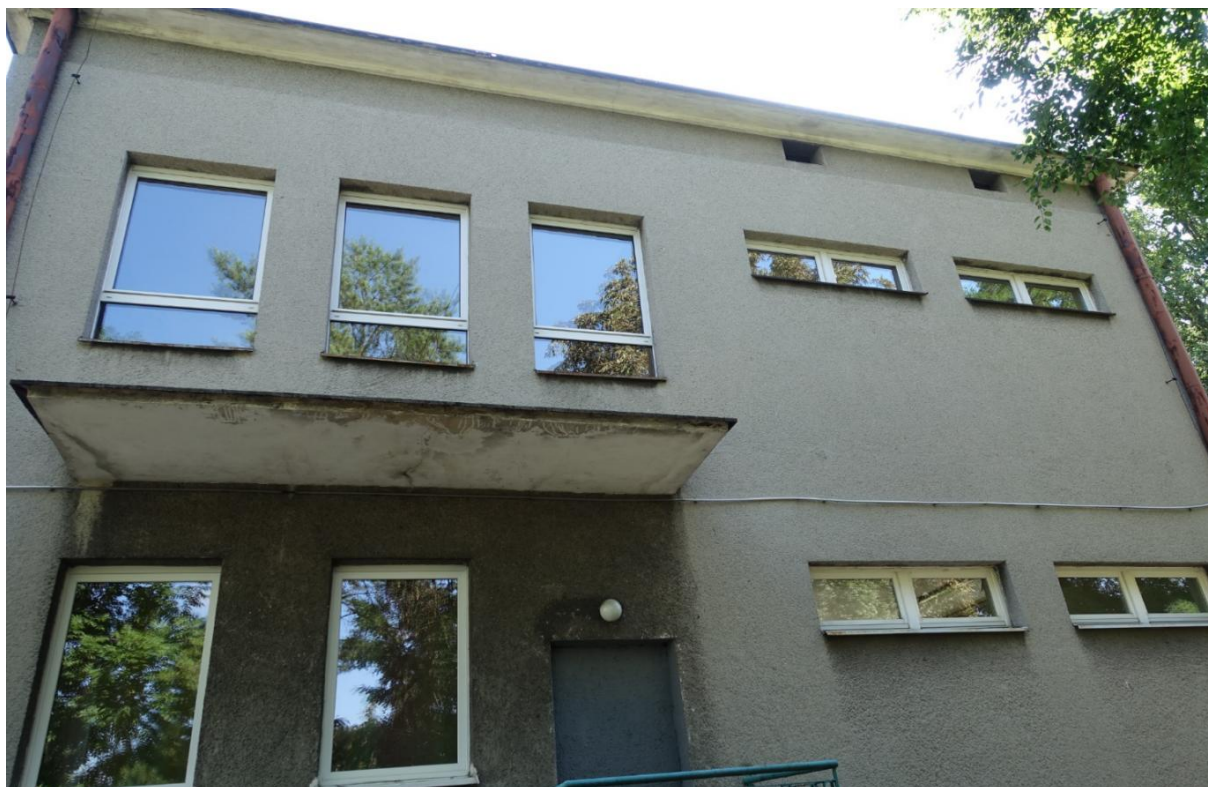
Fot. 9. Elewacja zachodnia z oknami w których mogą gnieździć się ptaki.
