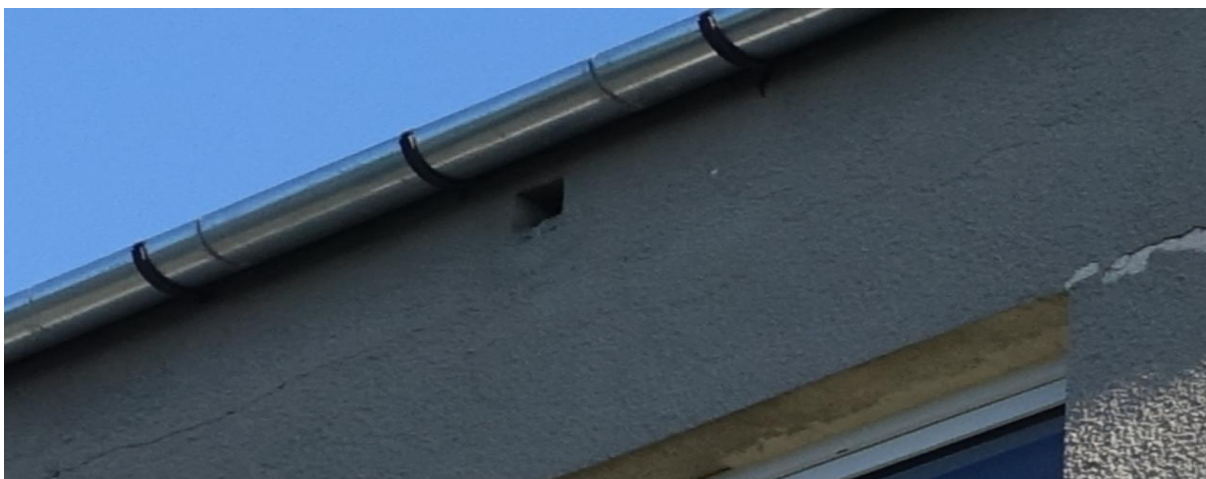
Fot. 7. Zbliżenie niezabezpieczonego otworu wentylacyjnego.
