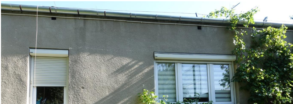
Fot. 10. Zbliżenie niezabezpieczonych otworów wentylacyjnego w budynku sali gimnastycznej.
