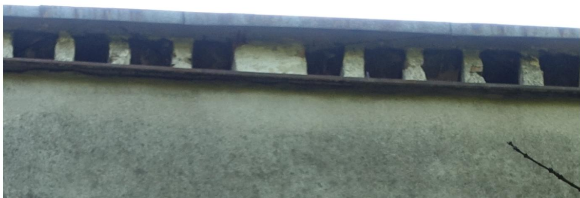
Fot.15. Przewody kominowe bez założonych siatek zabezpieczających.
