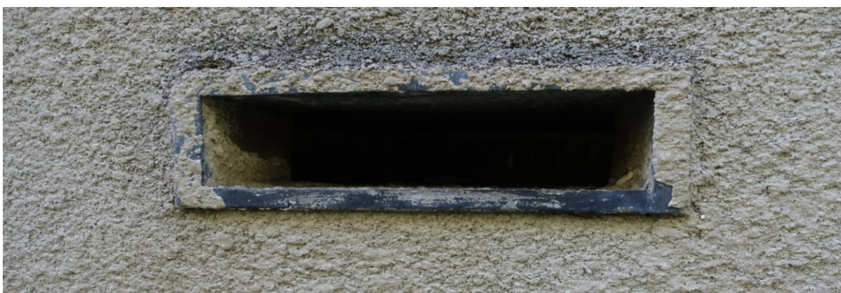
Fot.12. Elewacja zachodnia sali gimnastycznej. Szczelina stanowi potencjalne miejsce gniazdowania ptaków z rzędu wróblowate.
