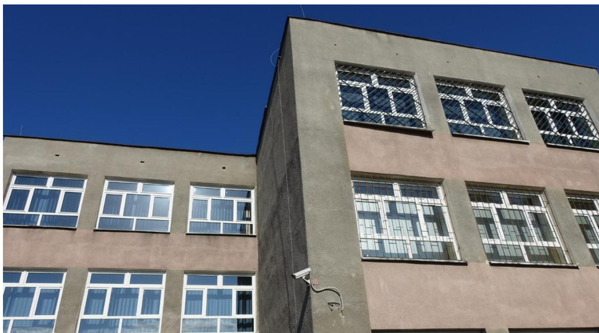
Fot. 6. Elewacja wschodnia z widocznymi niezabezpieczonymi otworami wentylacyjnymi stanowiącymi potencjalne siedliska gatunków chronionych.
