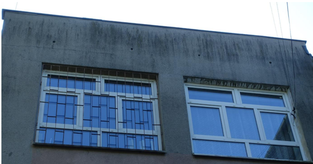
Fot. 5. Widok elewacji wschodniej z widocznymi niezabezpieczonymi otworami wentylacyjnymi stanowiącymi potencjalne siedliska gatunków chronionych.
