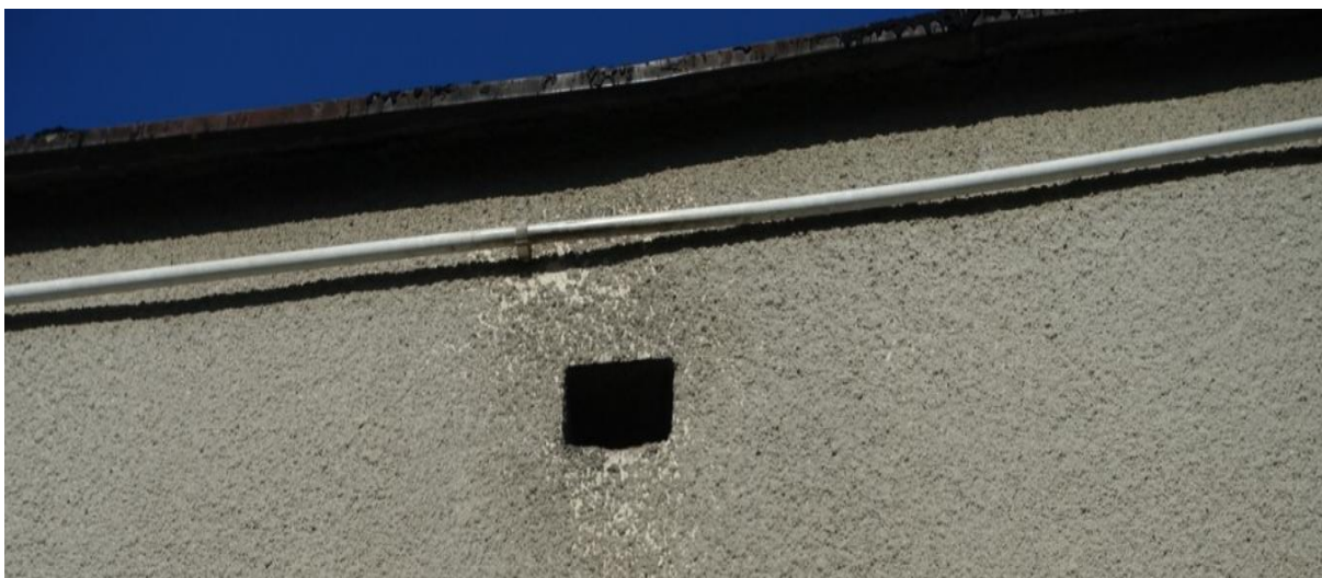
Fot. 9. Niezabezpieczone otwory wentylacyjne w budynku sali gimnastycznej.
