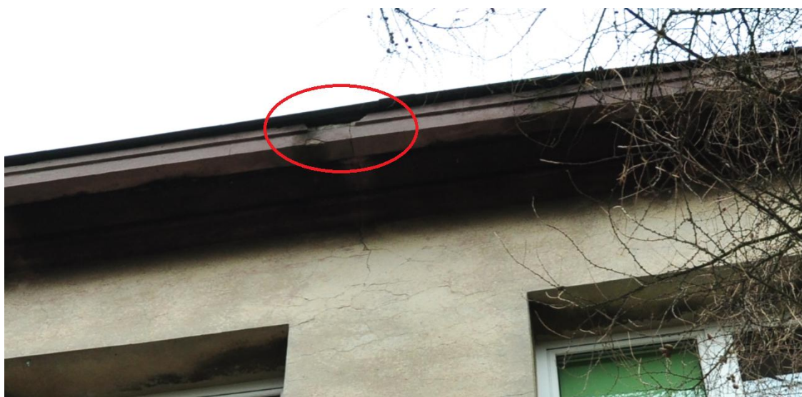
Fot. 10. Ubytki w gzymsie – potencjalne siedlisko dla wróbli .
