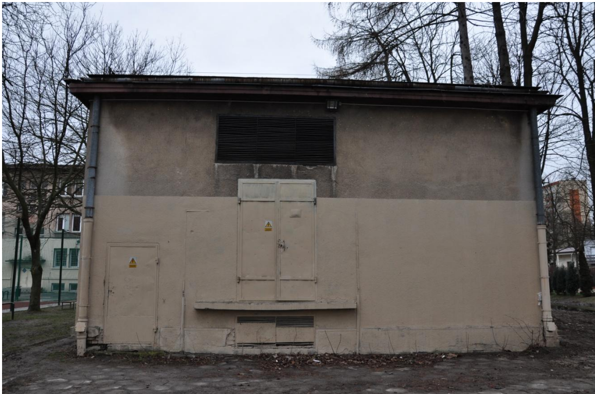
Fot. 6. Hala sportowa – elewacja wschodnia.
