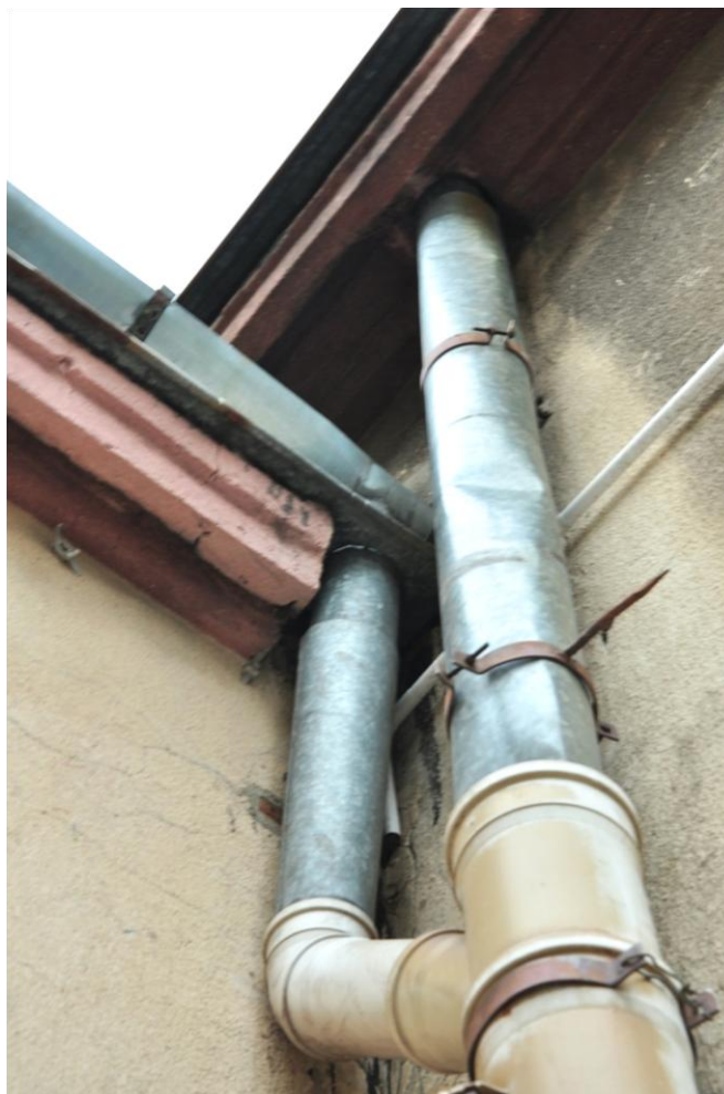
Fot. 14. Ubytki w gzymsie i szczeliny przy wejściu rur spustowych do okapu stanowiące potencjalne siedlisko dla wróbli i innych gatunków z rzędu wróblowatych.
