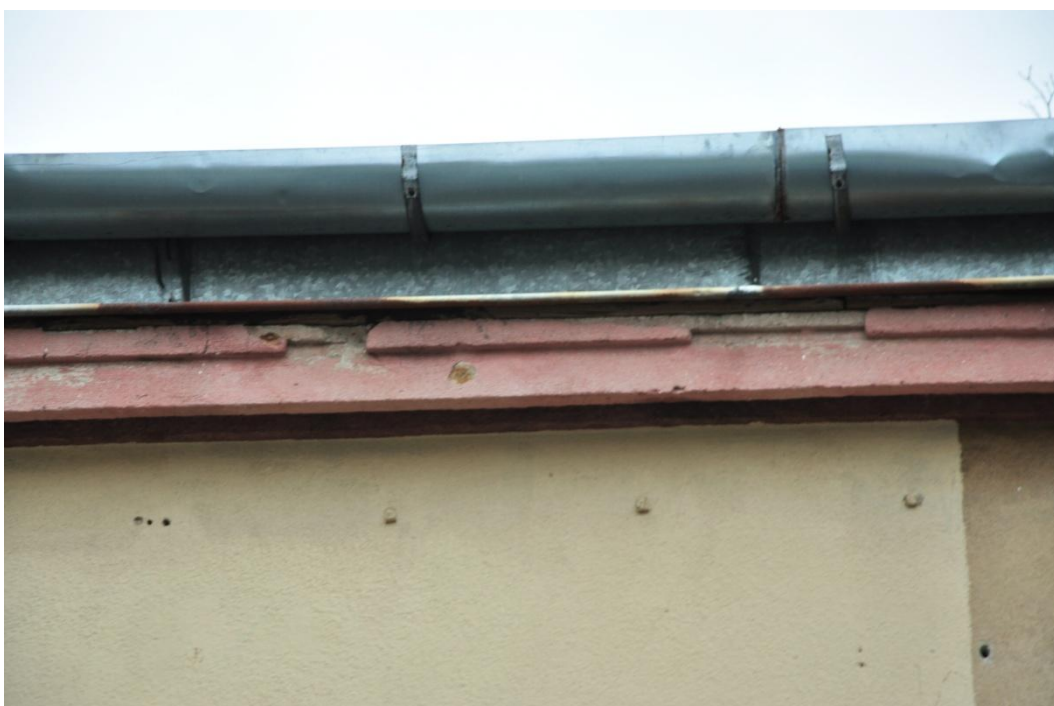
Fot. 13. Uszkodzenia gzymsu, mogące stanowić ptasie siedliska.
