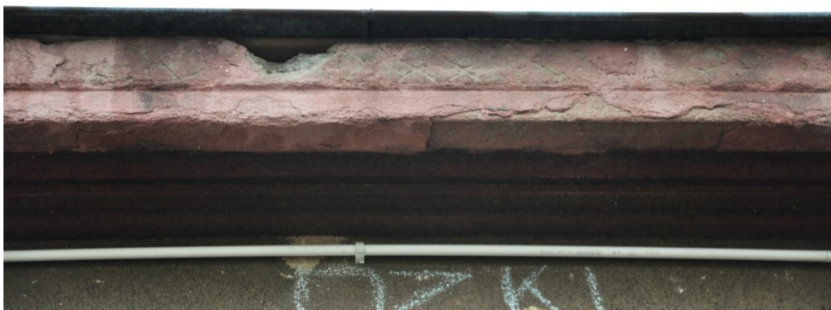
Fot. 15. Ubytki w gzymsie, stanowiące potencjalne siedlisko wróbli.
