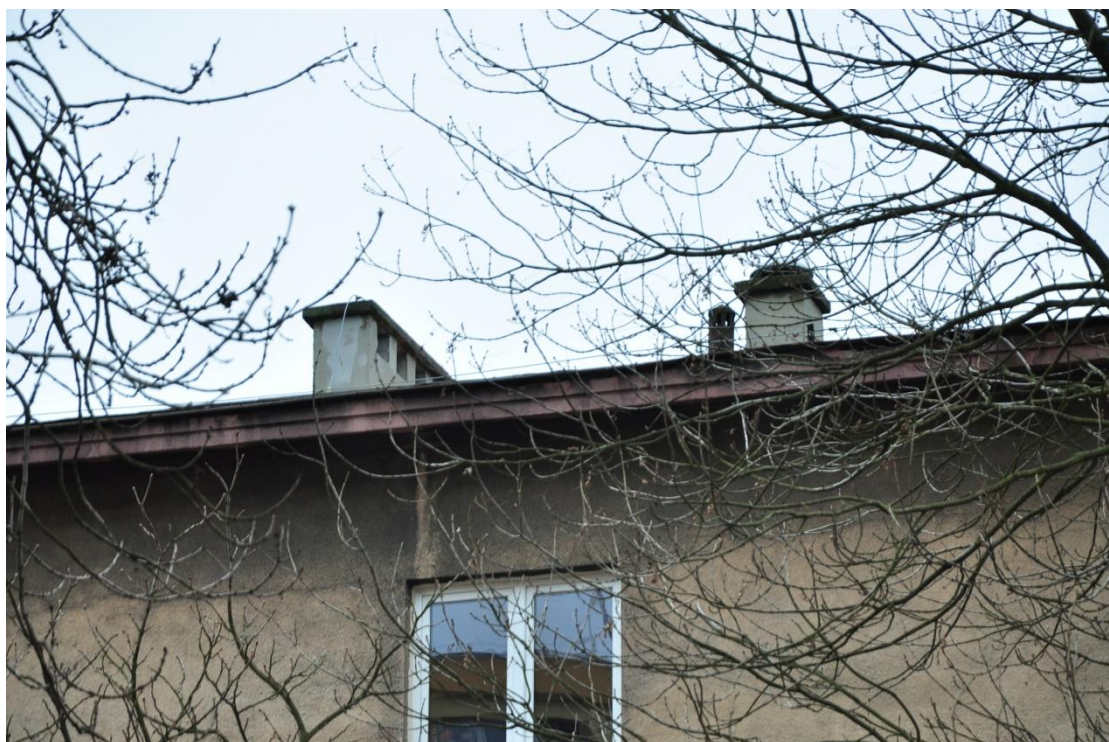
Fot. 18. Niezabezpieczone otwory wentylacyjne w kominach – potencjalne siedlisko dla gołębia i kawki.
