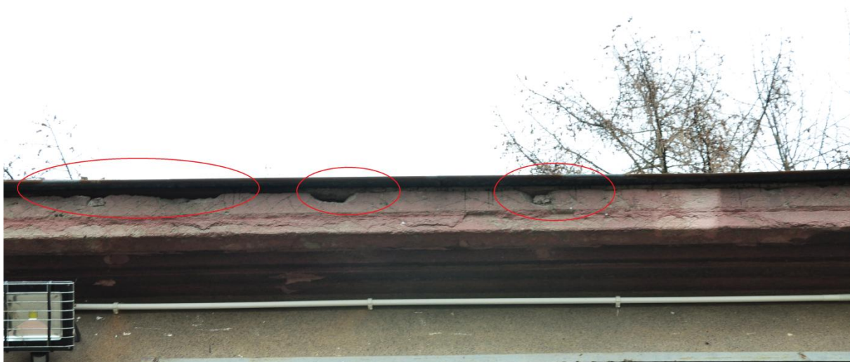
Fot. 16. Ubytki w gzymsie, stanowiące potencjalne siedlisko wróbli.
