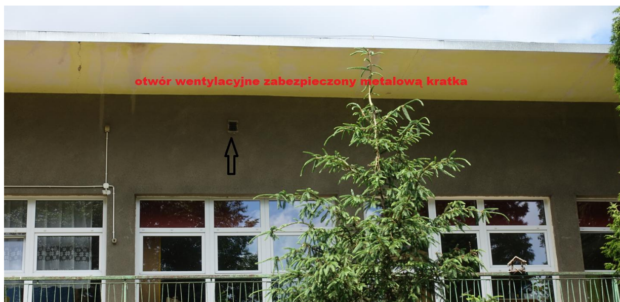
Fot. Nr 8. Elewacja południowa budynku Samorządowego Przedszkola nr 79 ul. Widok 23 z widocznym zabezpieczeniem otworu wentylacyjnego.
