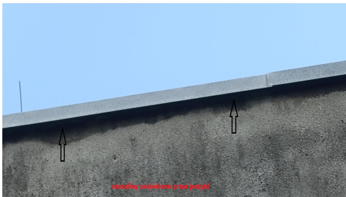
Fot. Nr 6. Elewacja wschodnia budynku Samorządowego Przedszkola nr 79 zasiedlona przez gatunki chronione.
