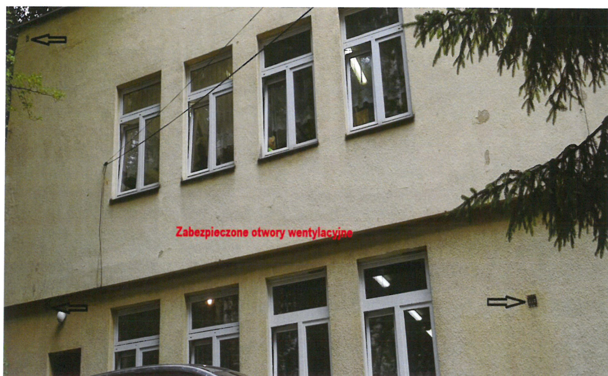
Fot. Nr 6. Inne ujęcie elewacji budynku od strony zachodniej z zabezpieczonymi otworami wentylacyjnymi uniemożliwiającymi zasiedlenie przez gatunki chronione.
